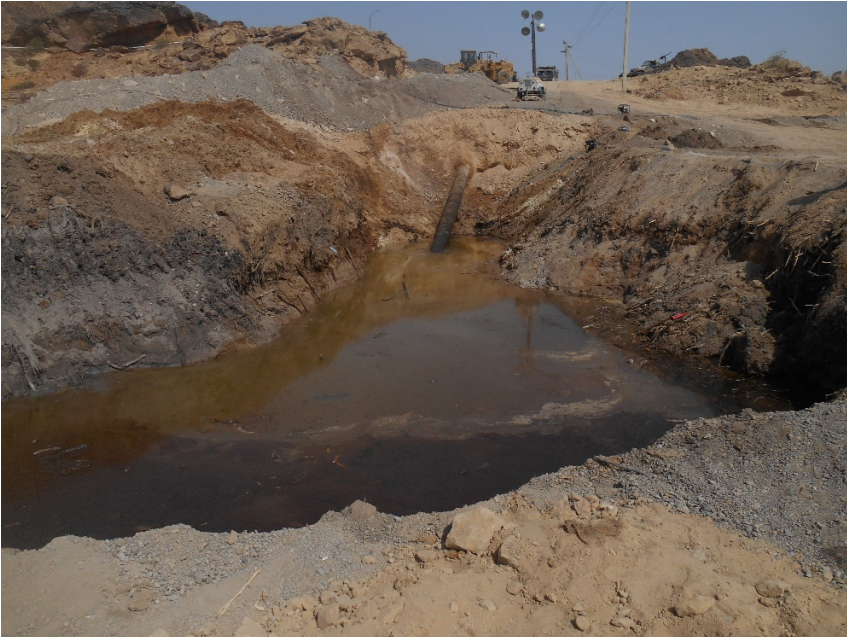
شكل (٦-٥) حفرة بطول 20 متر وعرض 5 متر مشبعة بالمياه والنفط حول الانبوب المتهالك
